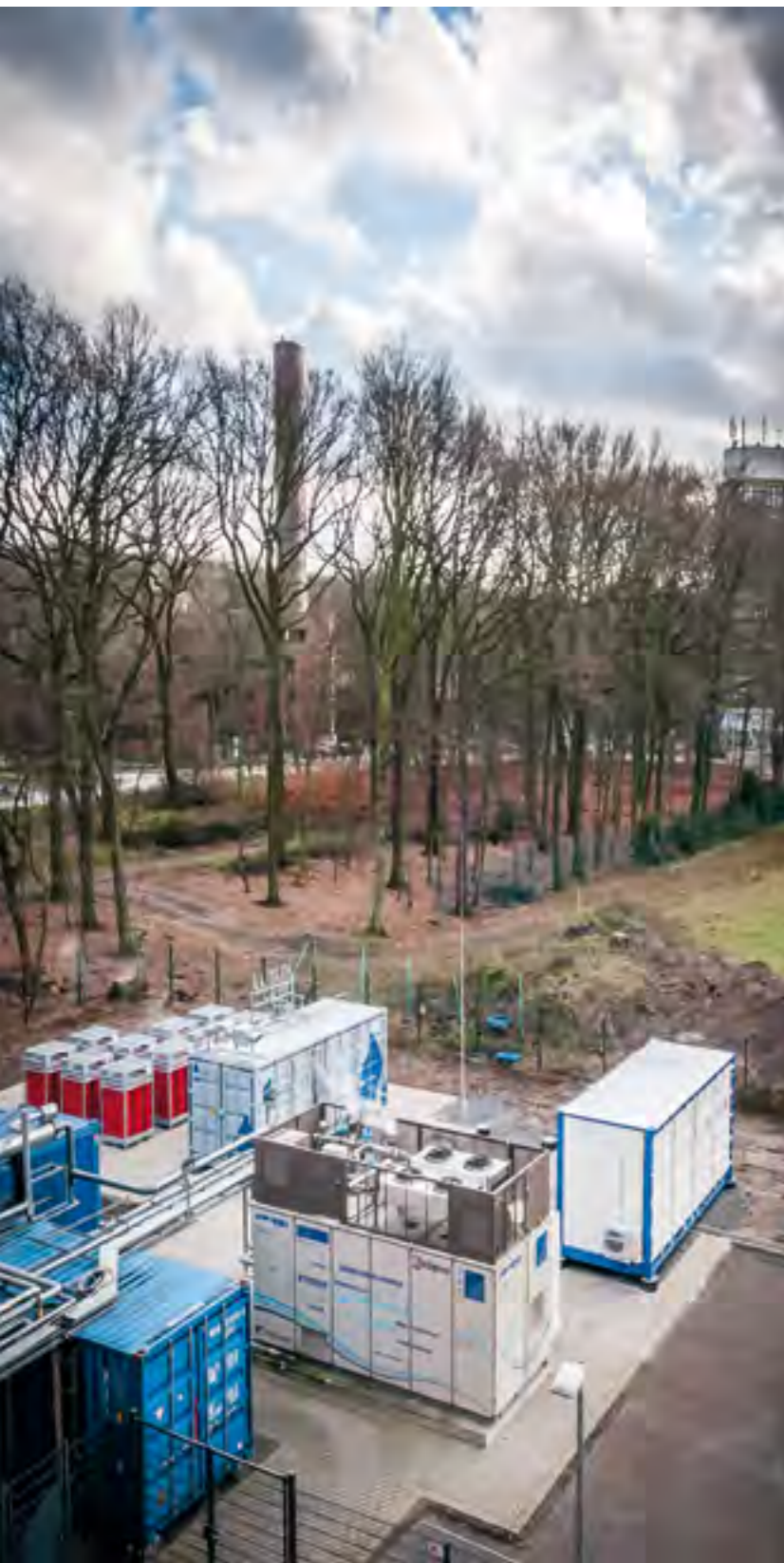
Testfeld mit Elektrolyseanlagen, Speicher und Brennstoffzellen-Blockheizkraftwerk Test field: electrolyser, hydrogen storage and fuel cell combined heat and power unit
